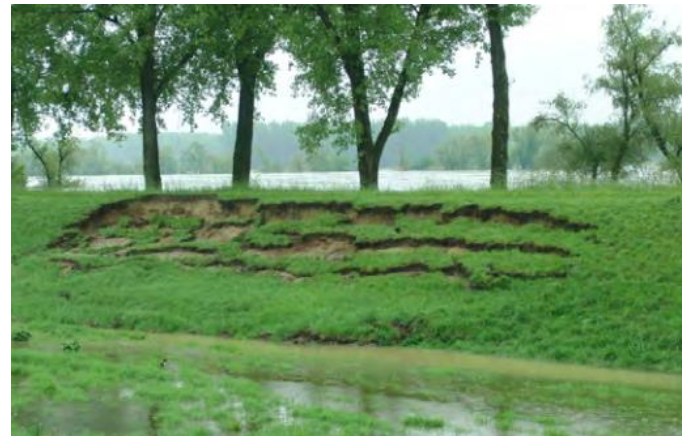
Rutschung an der Böschung eines Deichs während eines Hochwassers Quelle: WWA Deggendorf
