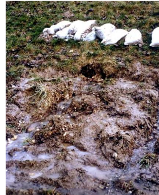
Sickerwasseraustritt im Bereich abgestorbener und teilweise verrotteter Wurzeln an einem Deich bei Ruckasing an der Donau während des Hochwassers 1988 (Foto: WWA Deggendorf Quelle: Haselsteiner, 2003)
