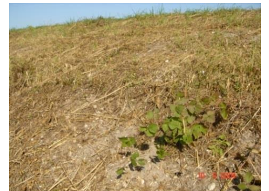
Fehlende Vegetationsdecke an einem Deich an der Loisach in der Nähe von Schlehdorf Quelle: R. Haselsteiner
