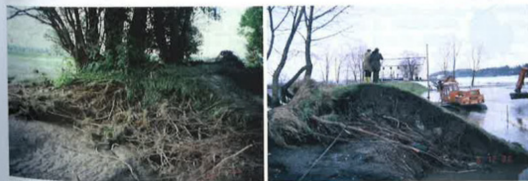
Abbildung 5: Wurzeln in Deichen an der Ammer (links) und an der Donau (rechts) nach Deichbrüchen 1999 und 1988 (Quelle: Wasserwirtschaftsverwaltung Bayern)
