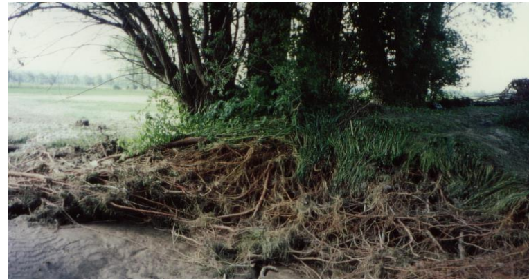
Deichbruch an der Ammer HWS1999 (Quelle: WWA Weilheim)
