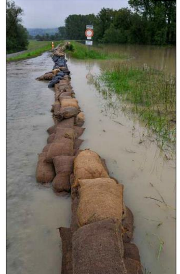
Der Isardamm bei Fischerdorf am Dienstag, 4. Juni, gegen Mittag: Wenig später brach der Deich an dieser Stelle. – F.: M. Birgmann
