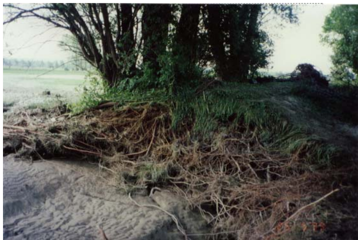
Abb. 3: Deichbruch an der Ammer bei Pschorrn während Hochwasser 1999 (Quelle: WWA Weilheim, Bayern)
