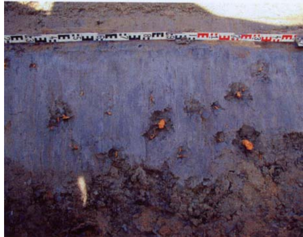
Abb. 20: Durchwurzelte Dichtung eines Dammes (aus Kunz 2001)
