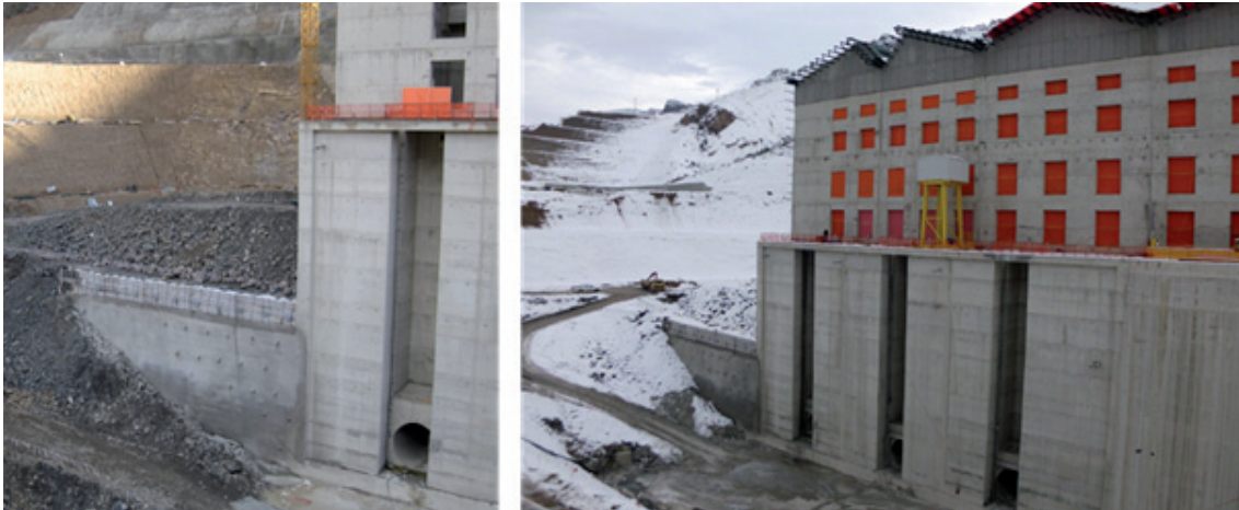
Abbildung 14: Baufortschritt im Januar 2013 – 30 % von KKD1 - Unkritischer Baustopp von KKD1 zugunsten der Bauarbeiten im Krafthaus – Zufahrtsrampe zur Installation von Maschinenteilen für eine der Turbinen
