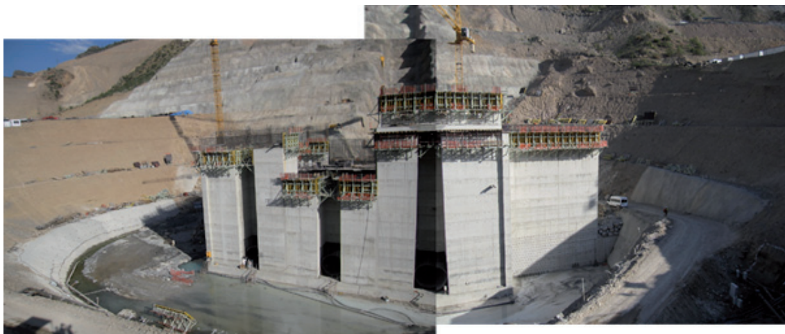
Abbildung 11: Ausgangszustand vor der Errichtung der mit Secugrid-Geogittern bewehrten Wände KKD1 und KKD2 (Mai/Juni 2012)
