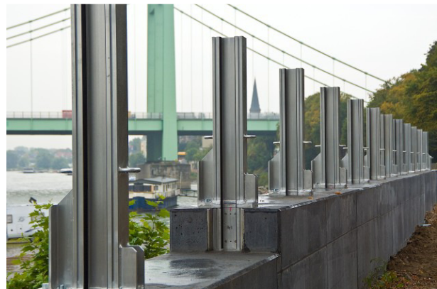
HWS-Wand mit aufgesetztem Dammbalkensystem in einer Großstadt am Rhein (Quelle: StEB Köln)
